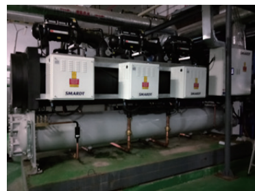
EMC 节能改造空调制冷冷水机组设备
