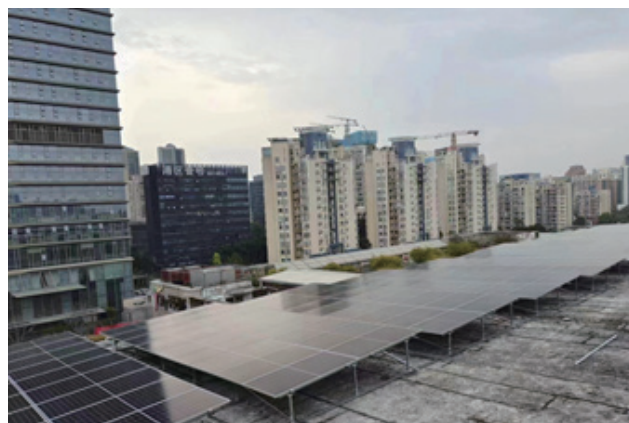
蛇口花园城屋顶光伏项目
