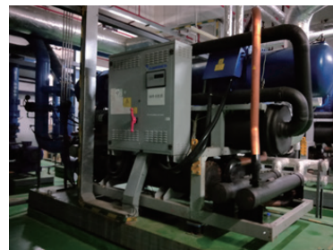
深圳希尔顿南海酒店原有空调制冷冷水机组设备
